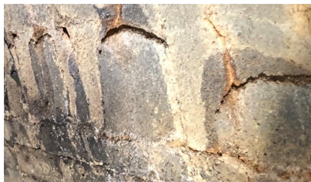
Muffel Abplatzungsanrisse für grössere Abplatzungen
